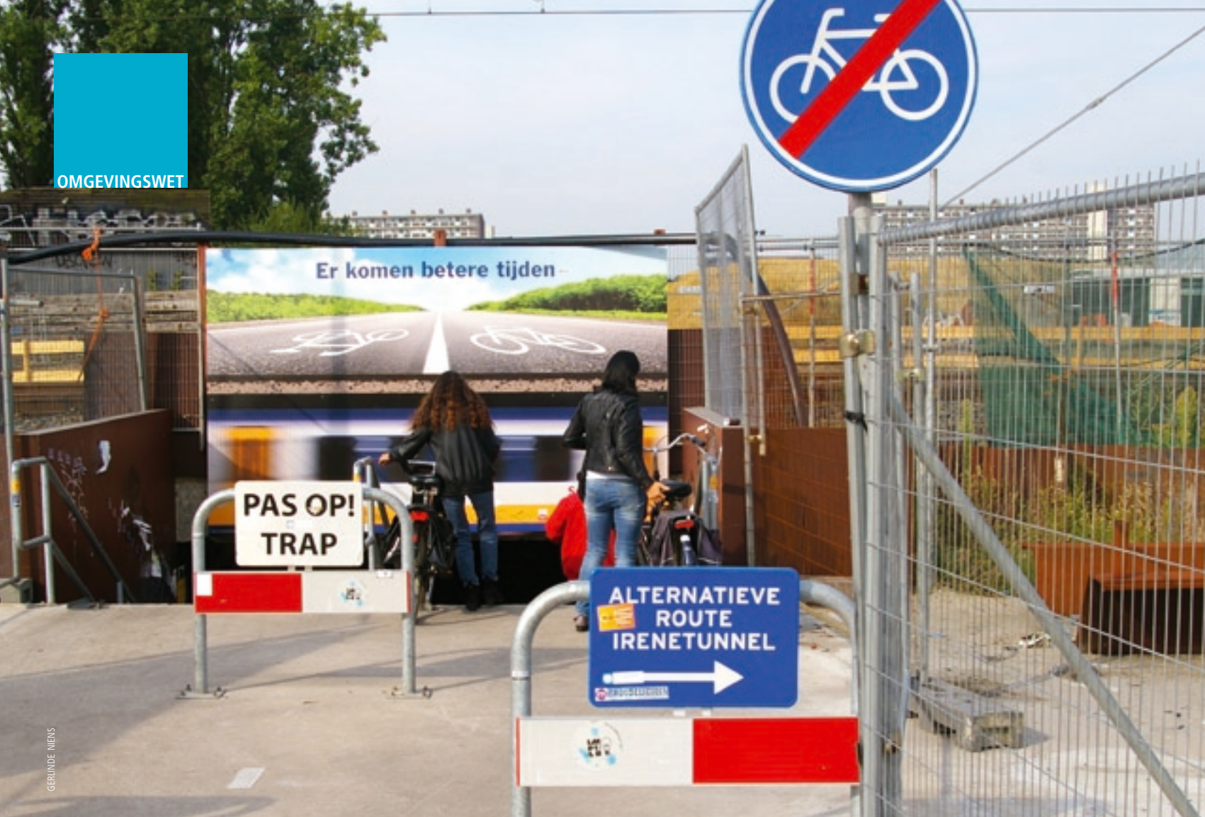
De aanleg van een tunnel onder het spoor in Delft brengt tijdelijk ongemakken met zich mee.
